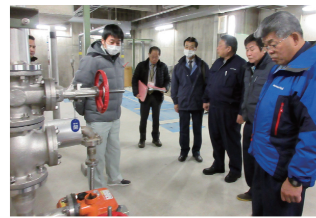
浜小清水地区農業集落排水処理場
